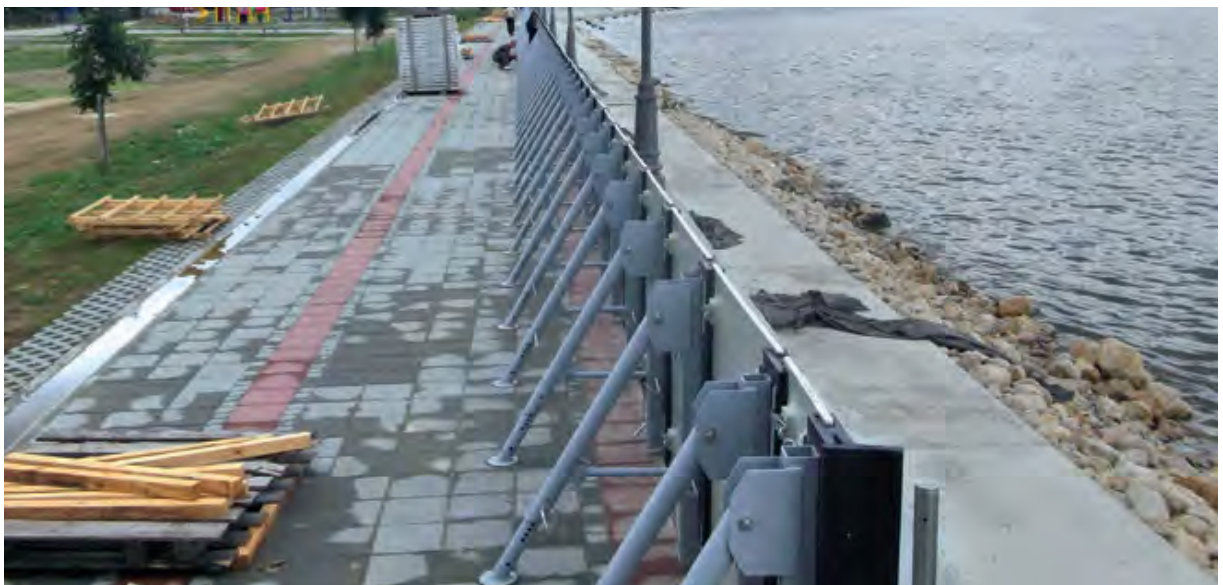
Hochwasserschutz mit Hochwasserschutzplatten aus Kunststoff
