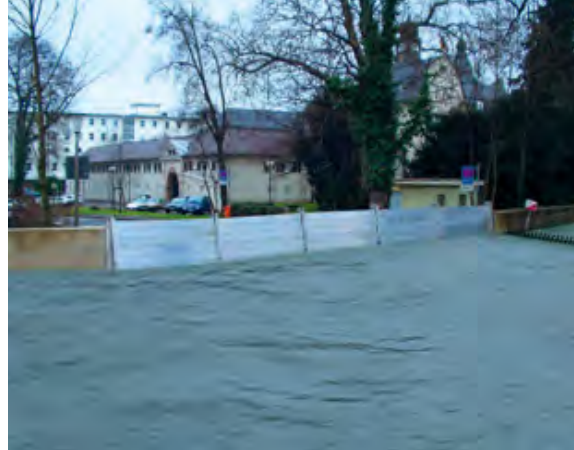
Mobiler Hochwasserschutz mit Dammbalken
