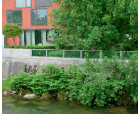
Hochwasserschutzwand mit Sicherheitsglas
