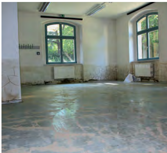
Durchfeuchtete Außenwand nach Überflutung
