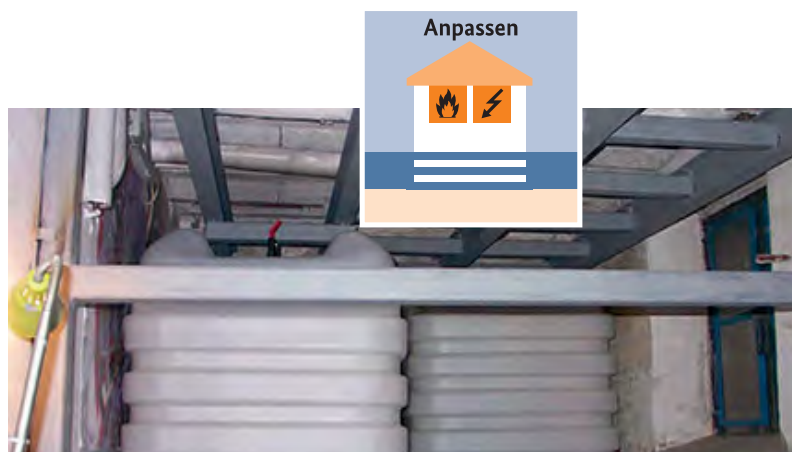
Anpassen: zum Beispiel durch Sicherung bestehender Tankanlagen
