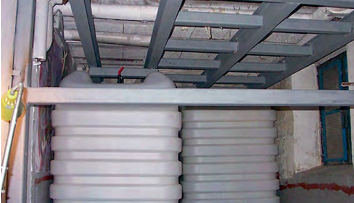
Heizöltankanlage mit Auftriebssicherung
