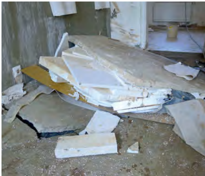
Aufgeschwommener schwimmend verlegter Zementestrich
